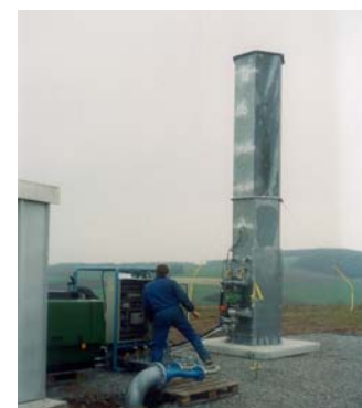
Landfill gas flare
