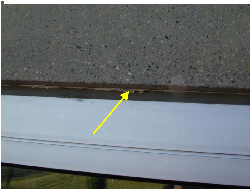
Reste des alten PCB-haltigen Fugenmaterials im Kontakt mit neuen Fensterfugen
