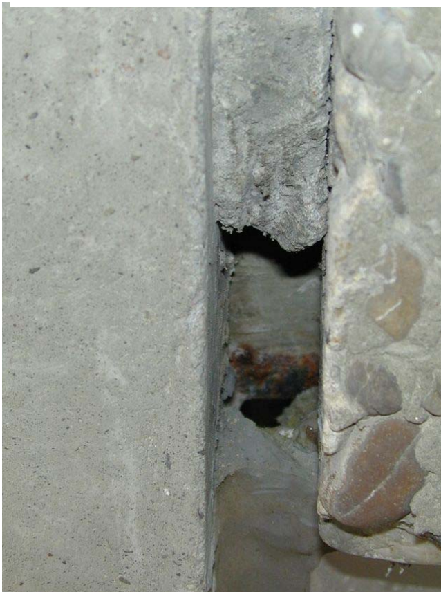
Fugendurchgänge (Mörteltaschen z.T. schlecht ausgeführt)
