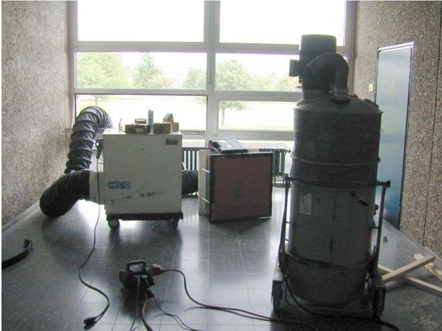
Geräte zur geregelten Lüftung und Luftwechsel incl. Filtereinrichtungen
