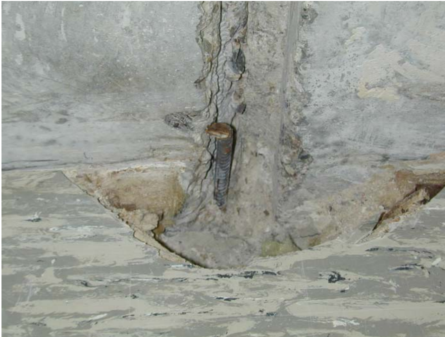
Ausgestemte Fugen im Übergang zum Estrich des Fußbodens
