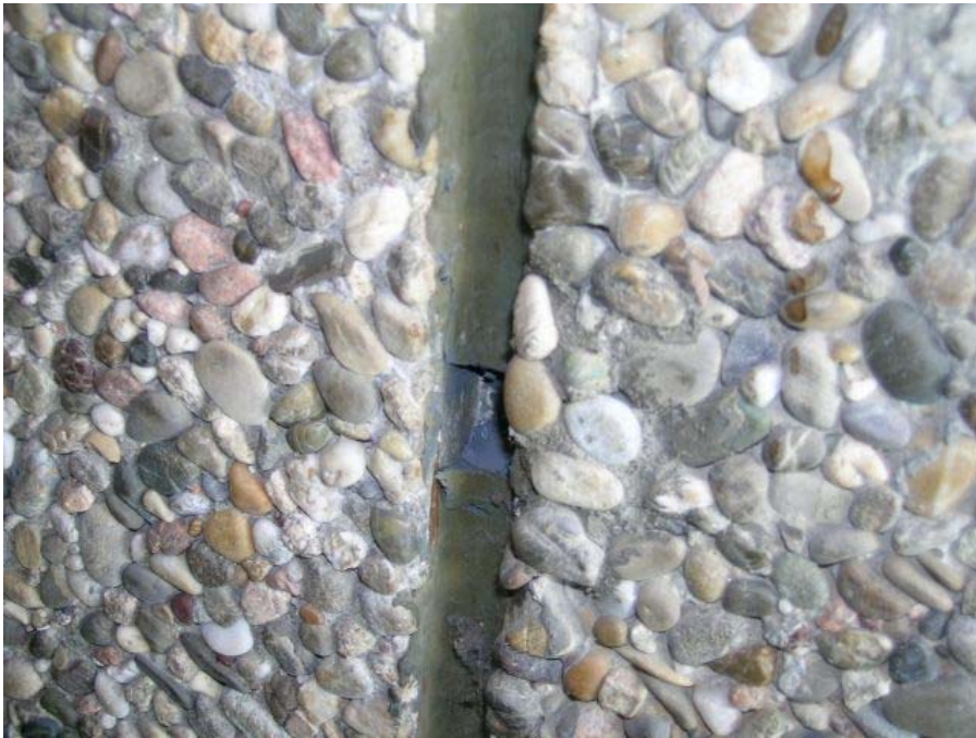
Dehnungsfuge im Aulabereich vor Sanierungsbeginn
